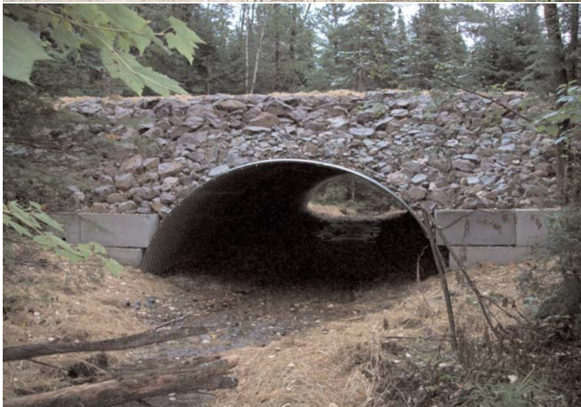
1. Pont à longerons en fer avec butée " bolt-a-bin " - photo courtoisie de Fornebu Lumber.
